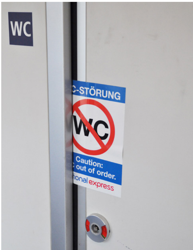
Defekte Toiletten verärgern die Fahrgäste
