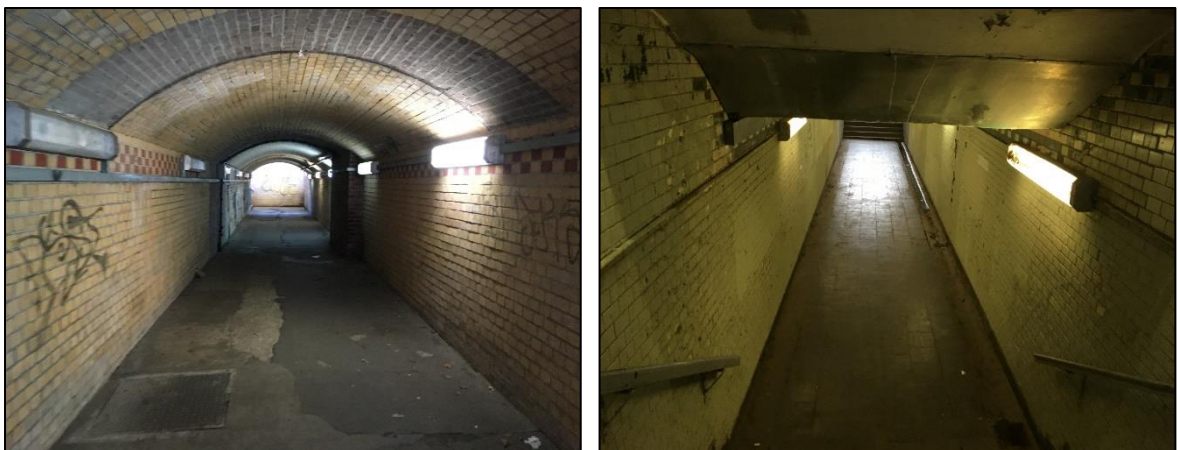
Abbildung 23: Beispiel unsanierte und schlecht beleuchtete Unterführung (eigene Fotos)
