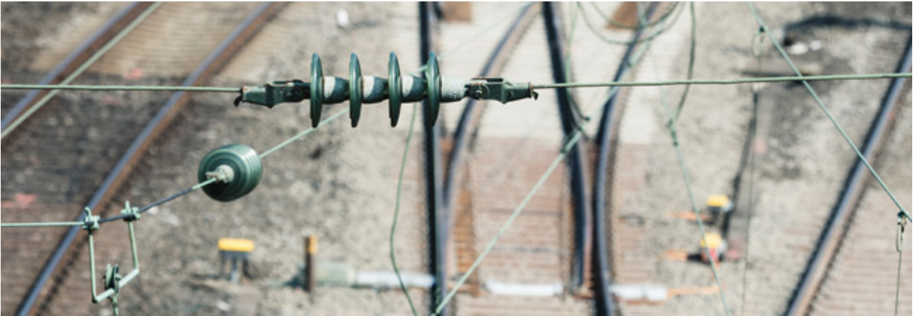
Die Elektrifizierung der Bahnstrecke zwischen Wesel und Bocholt birgt erhebliche verkehrliche und umweltpolitische Verbesserungspotenziale.
